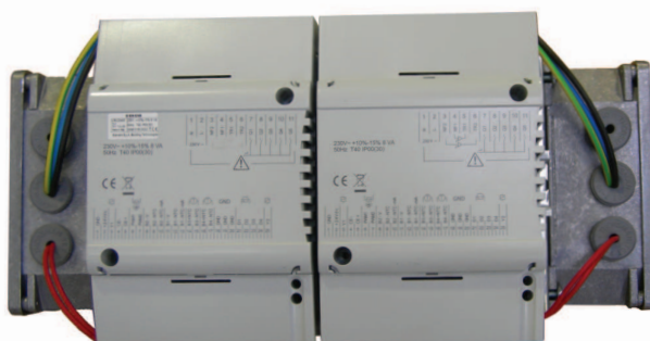
ШКАФ УПРАВЛЕНИЯ С КОНТРОЛЛЕРОМ
